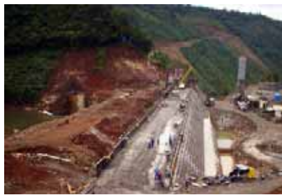
PCH São Bernardo / SHP São Bernardo
